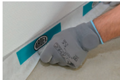
3. Le long des éléments montants et des évacuations du revêtement, installer des bandes périphériques d'insonorisation
